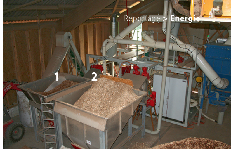
Pelletieranlagen-Know-how von ZM-Technik: Zwei Dosierschnecken mischen das feuchte (1) und trockene Hackgut (2) für den Produktionsprozess
